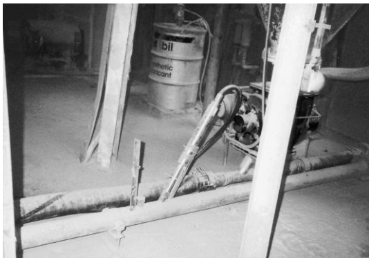
Bild 1: MTS 3D ORM Sensor in einer Zuleitung einer Mahlanlage der Südchemie in der Anlage erreichte der sensor eine Standzeit von 12 Jahren ohne Reperaturen
